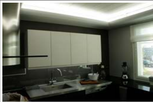
Keittiön epäsuora valaistus. Välitilassa 35 W:n IP64-Saalinki-valaisin ja Protector-suojaputki.
